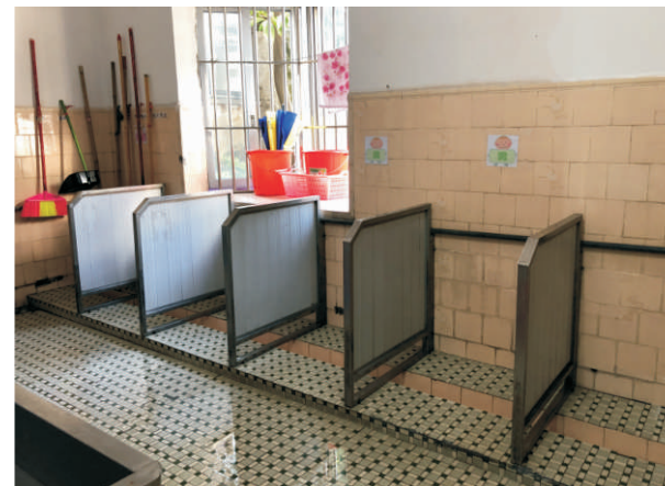
改造前的厕所仍使用落后的“屎坑”
